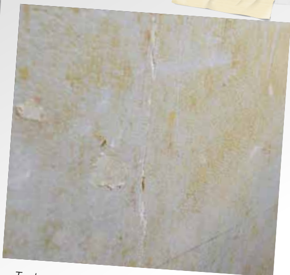
Tynk pod okładziną tapetową był już nieco wystłużony.
